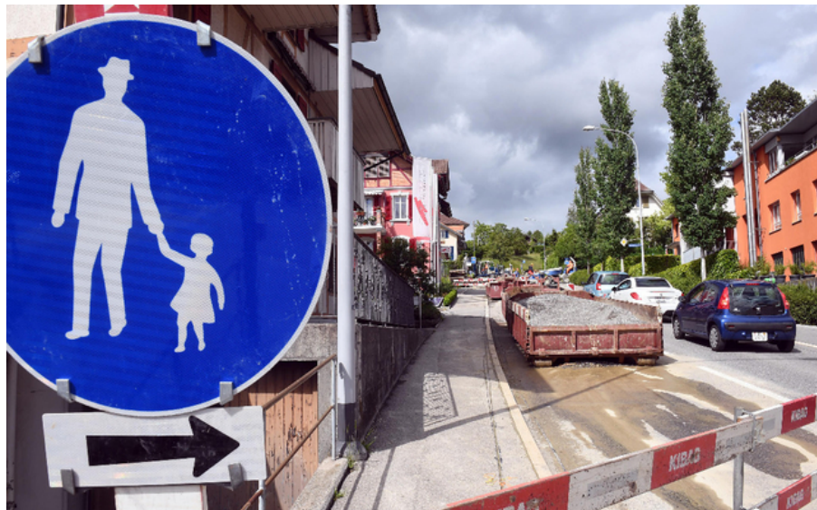
Gefährlicher Übergang: Im Bereich der heutigen Baustelle müssen die Schüler ab Sommer die Bolligenstrasse überqueren. Bild: Andreas Blatter
